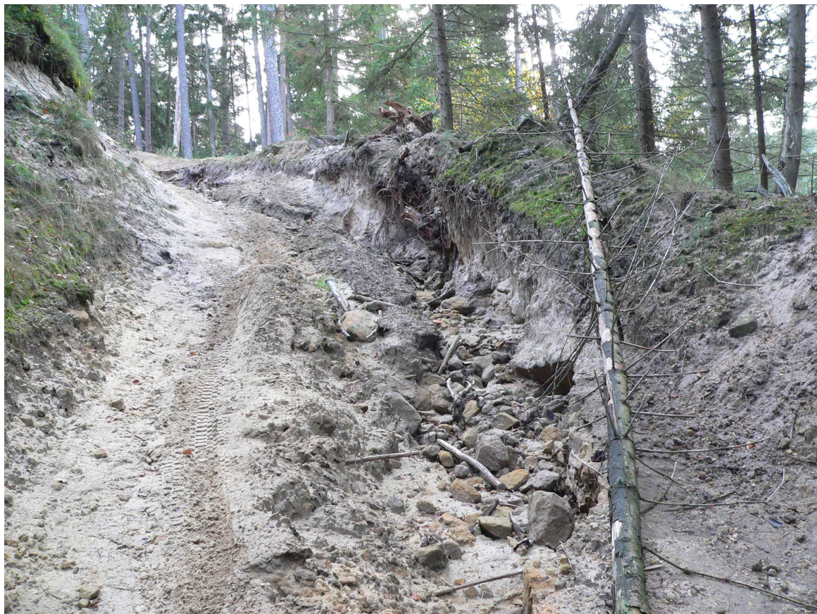
Obr. 4 - Hluboké erozní rýhy na lesní cestě kategorie 3L.
